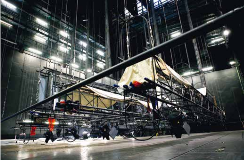
Oper Leipzig, Obermaschinerie der Hauptbühne
